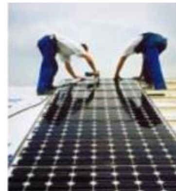
Systems 系統安裝與維運
